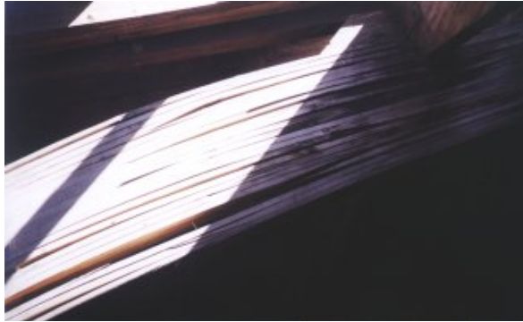
Fig. 1.1 – Delaminación en arco estructural [Foto: C. Meyer]
