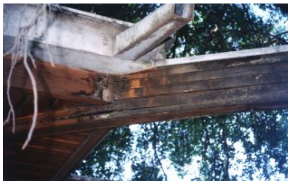
Fig. 1.2 – Comienzo de delaminación en viga con zona afectada por hongos [Foto: C. Meyer]
