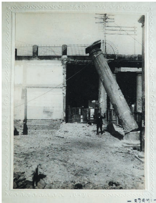
FIGURA 1. DEMOLICIÓN DE LA CONFITERÍA LA GIRALDA. SE VE EL INSTANTE EN QUE COMIENZA A CAER UNA DE LAS COLUMNAS DÓRICAS DE LA PASIVA. MONTEVIDEO (CA. MARZO DE 1922).
