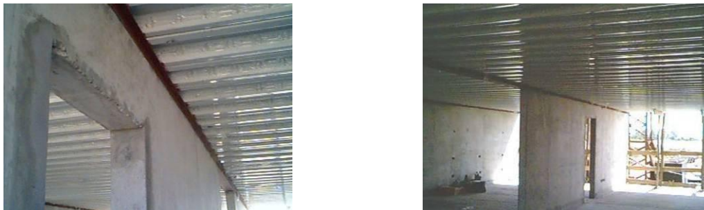
Figura 28 – Fotografías del encuentro pantalla y steel deck
