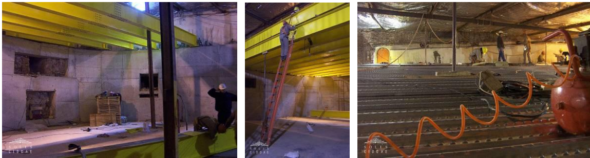
Figura 56 – Montaje del steel deck de la losa de la sala de máquinas
