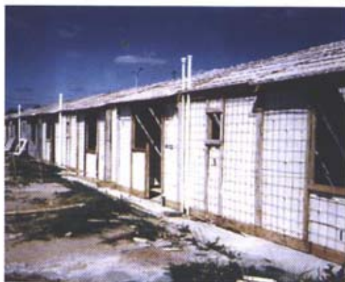
Paneles de poliestireno expandido con mallas electrosoldadas preparados en la planta de FUCVAM y cubiertos con mortero proyectado en obra. Cooperativa COVIFOEB e instituto COVIMA.
