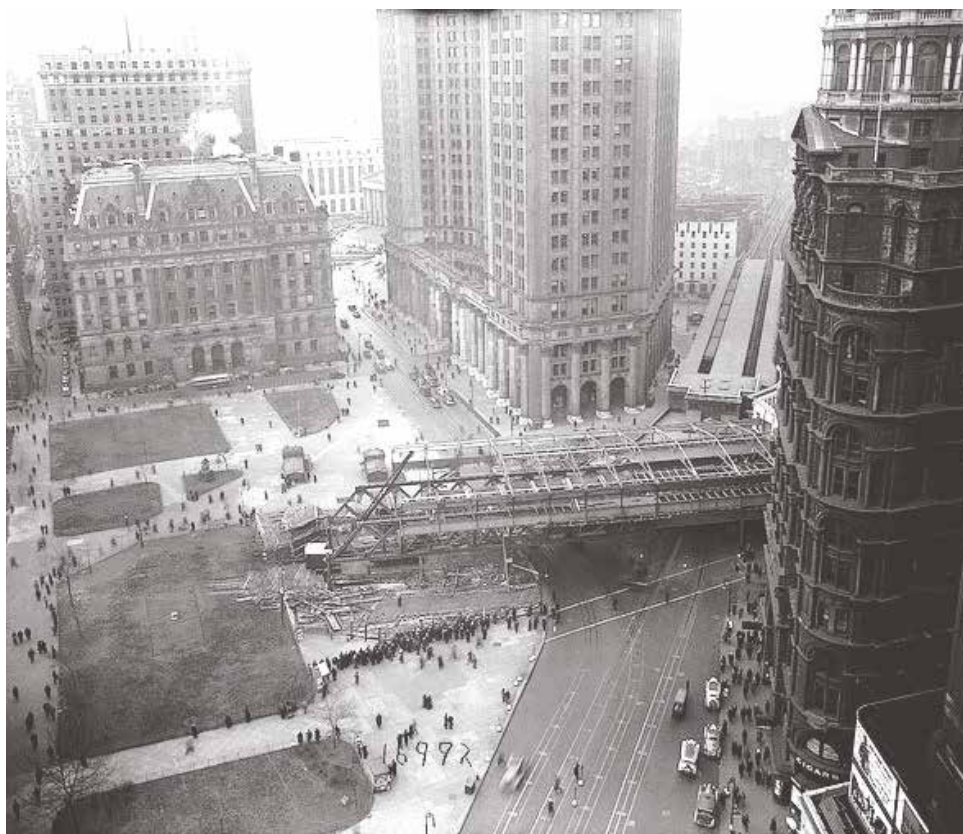
Fig.4.14 Demolición de la extensión de Park Row terminal sobre City Hall Park en 1935.
