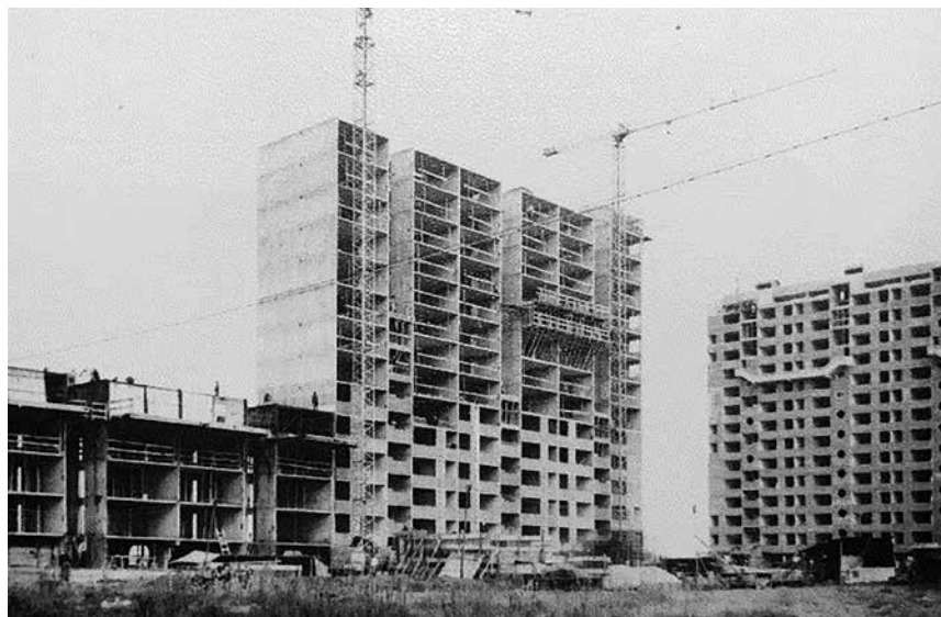
FIGURA 15. FOTOGRAFÍA DE LA CONSTRUCCIÓN DEL PARQUE MALVÍN ALTO CON SISTEMA OUTINORD. FONDO DE LOS CAMPOS, PUENTE Y TOURNIER. CENTRO DE DOCUMENTACIÓN DEL IH, FADU, UDELAR.
