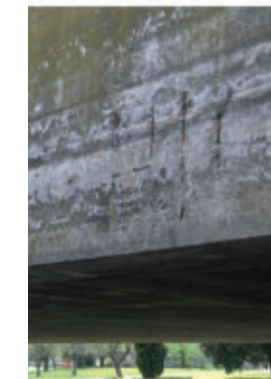
Fisuras verticales, armadura expuesta y colonización biológica, paramento exterior de viga baranda sector este
