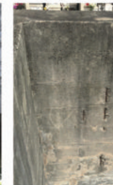
Fisuras verticales, armadura expuesta, eflorescencias y manchas, paramento exterior de viga baranda sector oeste
