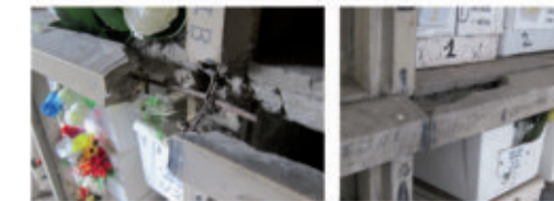
Rotura, manchado, desposicionamiento y armadura expuesta de marco de tapas inexistentes
