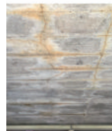
Fisuras transversales, manchas y eflorescencias
