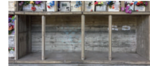
Colonización biológica y manchas en tabiques laterales y piso
