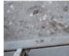
Fisuras asociadas a roturas y colonización animal (guano de paloma)
