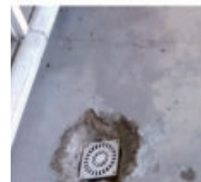
Fisura, rotura y colonización biológica
