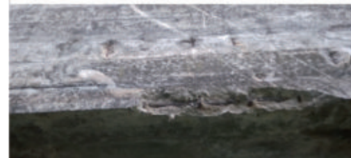
Fisuras verticales, desprendimiento en encuentro con cielorraso, armadura expuesta y manchas, paramento exterior de viga fachada sur
