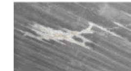
Grieta diagonal 45°, eflorescente y con manchas
