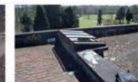
Vidrios rotos de lucernario
