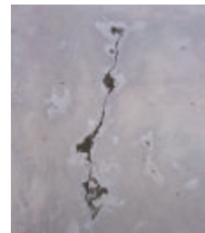
Fisura asociada a rotura, manchas y colonización biológica
