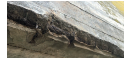
Desprendimiento, armaduras expuestas, corrosión y colonización biológica, paramento exterior viga baranda sector este
