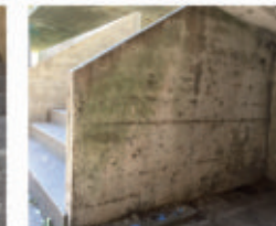
Colonización biológica y manchas en baranda
