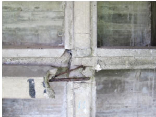
FIGURAS 16 y 17. Desplomes y roturas en marco de tapas inexistentes de estanterías de urnas. FOTOGRAFÍAS: J.J. Fontana
