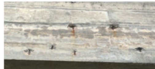
Fisuras verticales, desprendimiento, armaduras expuestas, corrosión y manchas, paramento exterior de viga fachada norte
