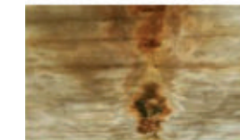
Grieta transversal, armadura expuesta y colonización biológica
