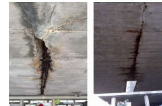
Armadura expuesta de carpeta inferior de losa nervada con síntomas de corrosión avanzada
