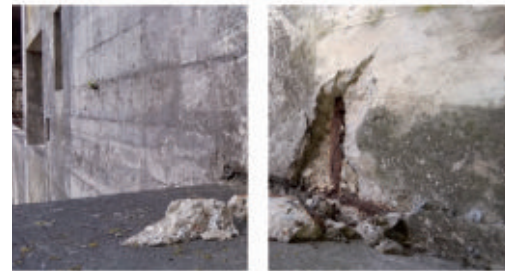
Desprendimiento de recubrimiento, armadura expuesta y corrosión en pilar
