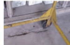
Fisura longitudinal asociada al desplazamiento de escalera móvil
