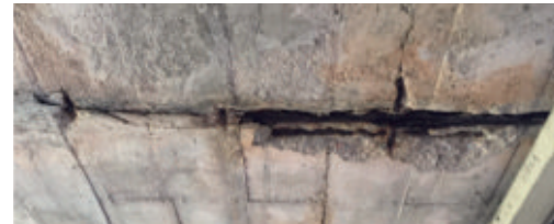
Grieta longitudinal y transversal con armadura expuesta, corrosión, manchas y desprendimiento
