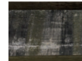
Manchas y colonización biológica, paramento exterior de viga baranda sector norte
