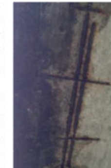
Desprendimiento, armadura expuesta y acumulación de agua
