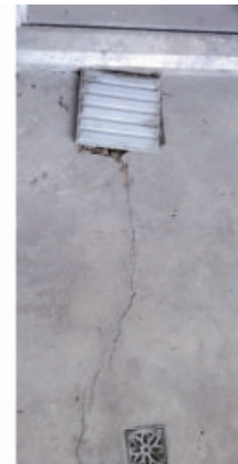
Fisura transversal y manchas
