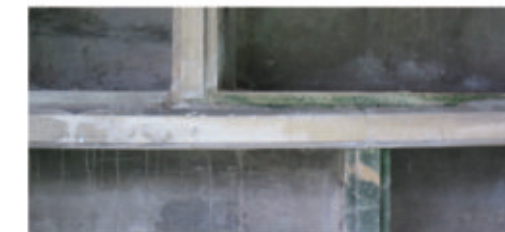
Colonización biológica, eflorescencias y manchas
