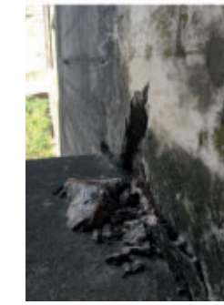
Rotura y armadura expuesta
