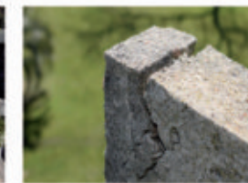
Grieta y desprendimiento en gárgola
