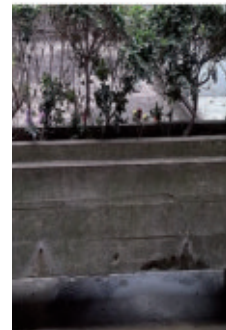
Desprendimiento y armadura expuesta en jardinera
