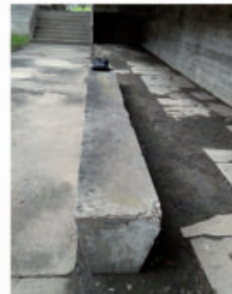
Rotura y desplomes en pavimentos
