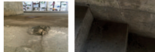
Fisura y rotura en contrahuella
