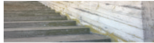
Colonización biológica, manchas y suciedad en escalones y barandas
