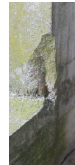
Fisura vertical, desprendimiento, armadura expuesta y corrosión, pilar al patio, sector este
