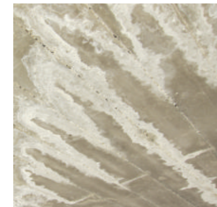
FIGURA 11. Fenómeno de armaduras «transparentes». FOTOGRAFÍA: J.J. Fontana.
