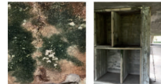
Colonización biológica en cielorraso y estanterías de urnas en PB, sector sur
