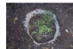
Obstrucción de desagüe
