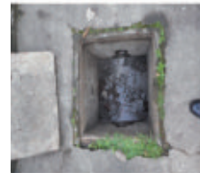
Colonización biológica y rotura en sistema de evacuación de pluviales
