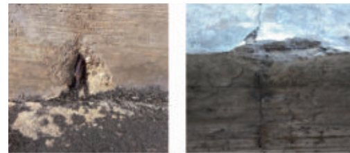
Desprendimiento, armadura expuesta y corrosión en paramento vertical de pilar y carpeta inferior de losa nervada
