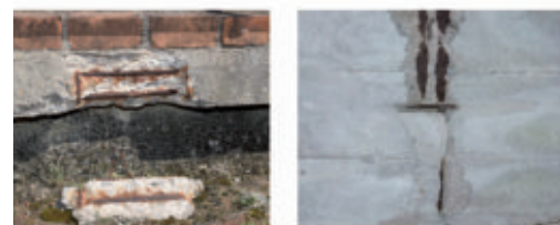
Desprendimiento en pretil
