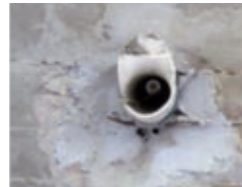
Desagüe incorporado, asociado a roturas, manchas, reparaciones y colonización biológica, manchas y eflorescencias. Vista desde piso 1.
