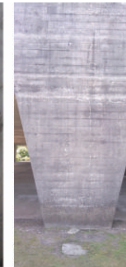
Fisura vertical y manchas, pilar perimetral, sector este
