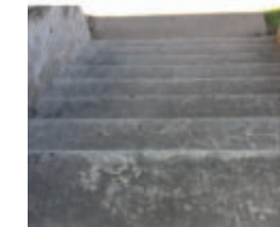
Craquelado y manchas en huellas
