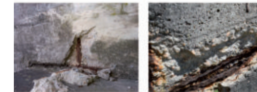
Armadura expuesta en vigas baranda, pilares y gárgolas de azotea
