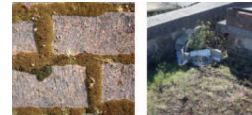
Musgo en juntas de tejas de terminación de azotea
