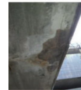
Grieta transversal y acumulación de agua
