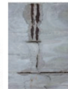
Grieta transversal, armadura expuesta
