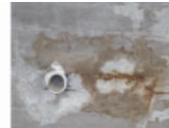
Desagüe incorporado, asociado a roturas, manchas, eflorescencias y reparaciones. Vista del cielorraso de PB
