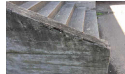
Colonización biológica, manchas, suciedad, desprendimientos, armadura expuesta y corrosión en barandas
