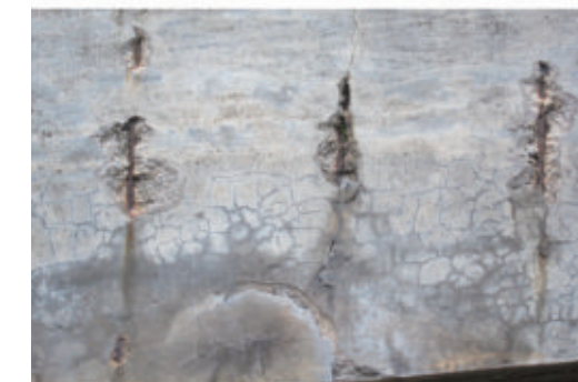
Armadura expuesta, corrosión, craquelado y reparaciones
