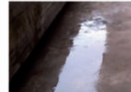
Fisuras en sectores con acumulación de agua
