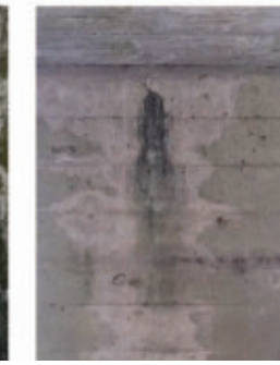
Eflorescencias y colonización biológica, paramento interior pilares perimetrales
