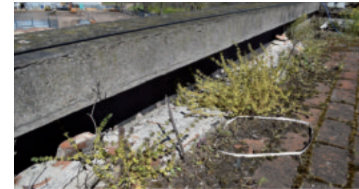
Fisuras y roturas en pretil, plantas de pequeño porte y musgo sobre tejuelas de terminación, acumulación de desechos y cableados no previstos
