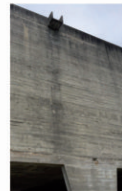
Manchas y suciedad paramento exterior viga fachada norte
