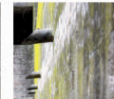
Colonización biológica, eflorescencias y manchas, paramento exterior y sector oeste
