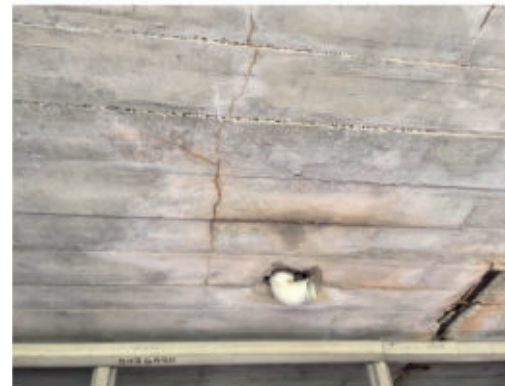
Grieta transversal, armadura expuesta, corrosión, manchas e incorporaciones disonantes
