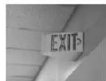
ILUMINACIÓN DE EMERGENCIA
